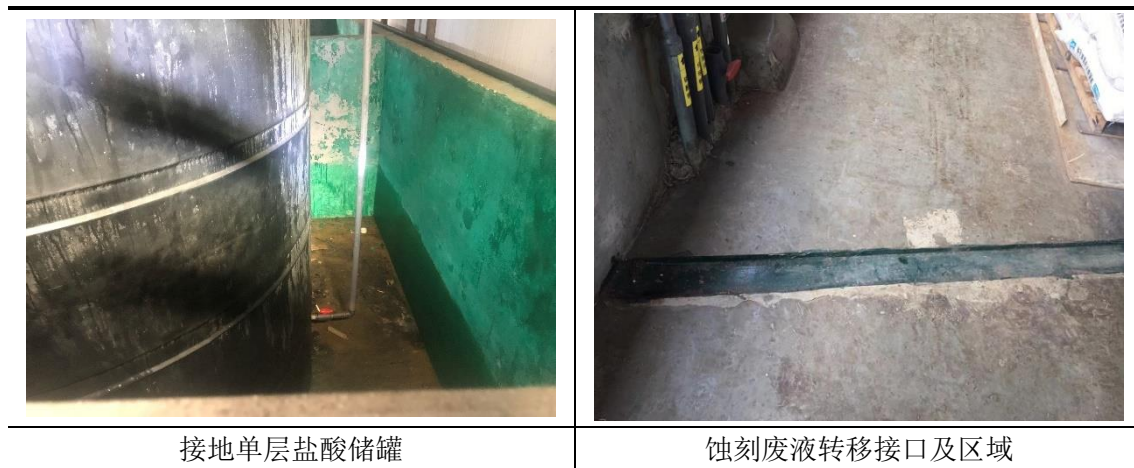
图 4.1.1 盐酸及废蚀刻液储罐设施现场情况
