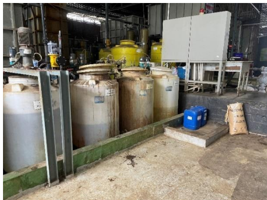
废水处理设施药剂添加剂管线及托盘
