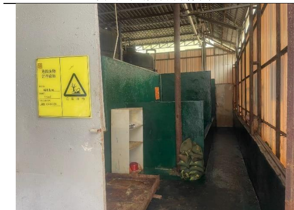
干膜渣、废树脂危险废物暂存间 3
