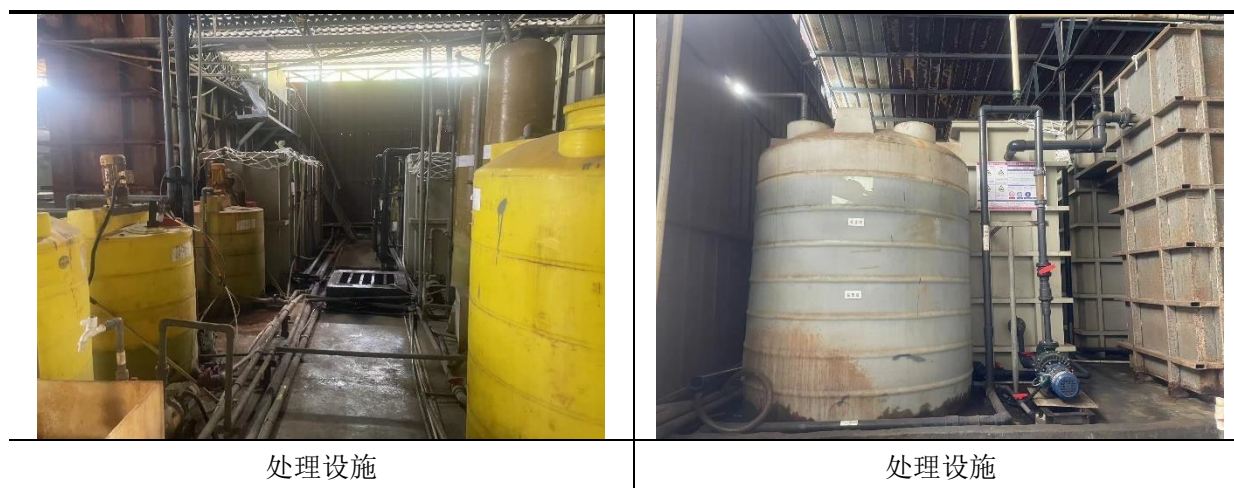
图 2.8.2 电镀废水处理设施
