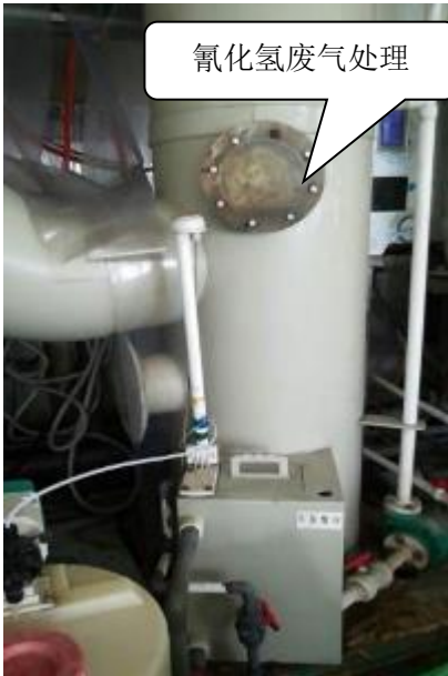
氰化氢废气处理设施
