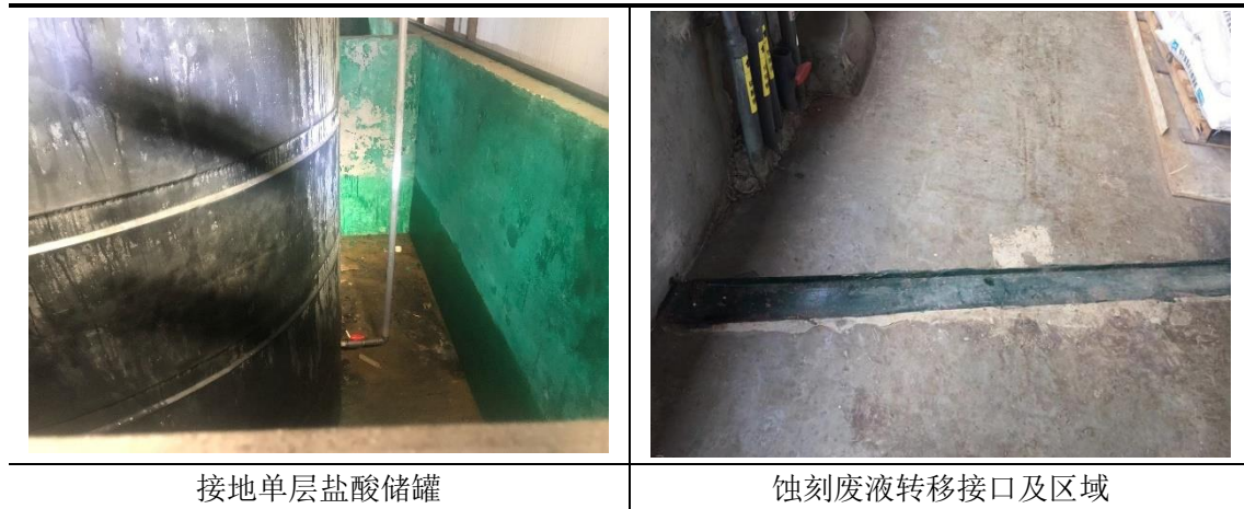
图 4.1.1 盐酸及废蚀刻液储罐设施现场情况
