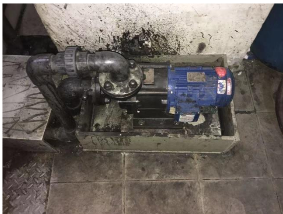
车间内循环泵防泄漏托盘
