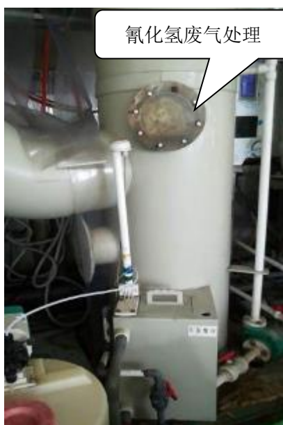
氰化氢废气处理设施
