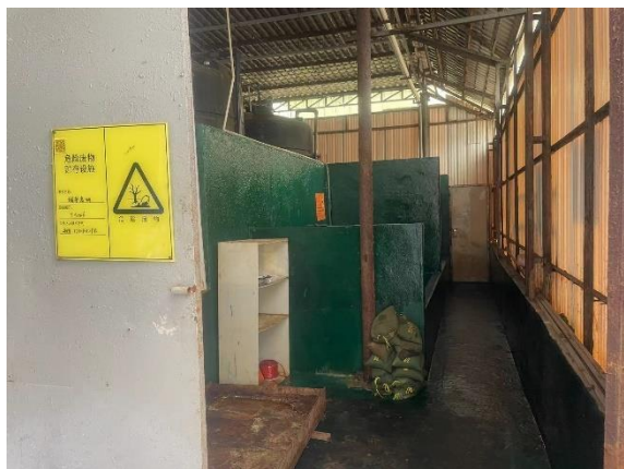
干膜渣、废树脂危险废物暂存间 3
