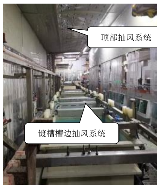
沉铜线抽风系统、镀槽收集
