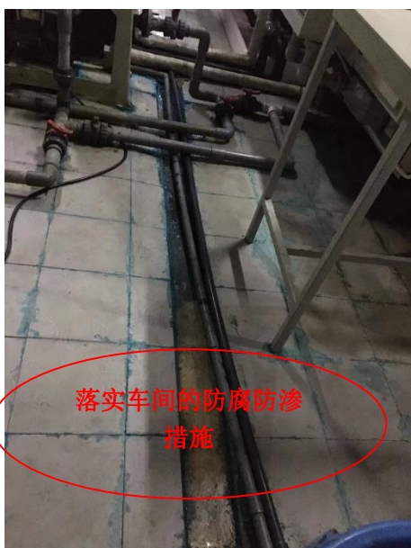
废水排放管线（明管明沟）
