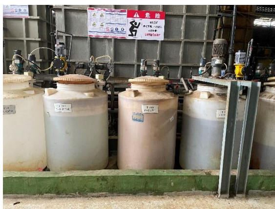
废水处理设施加药装置
