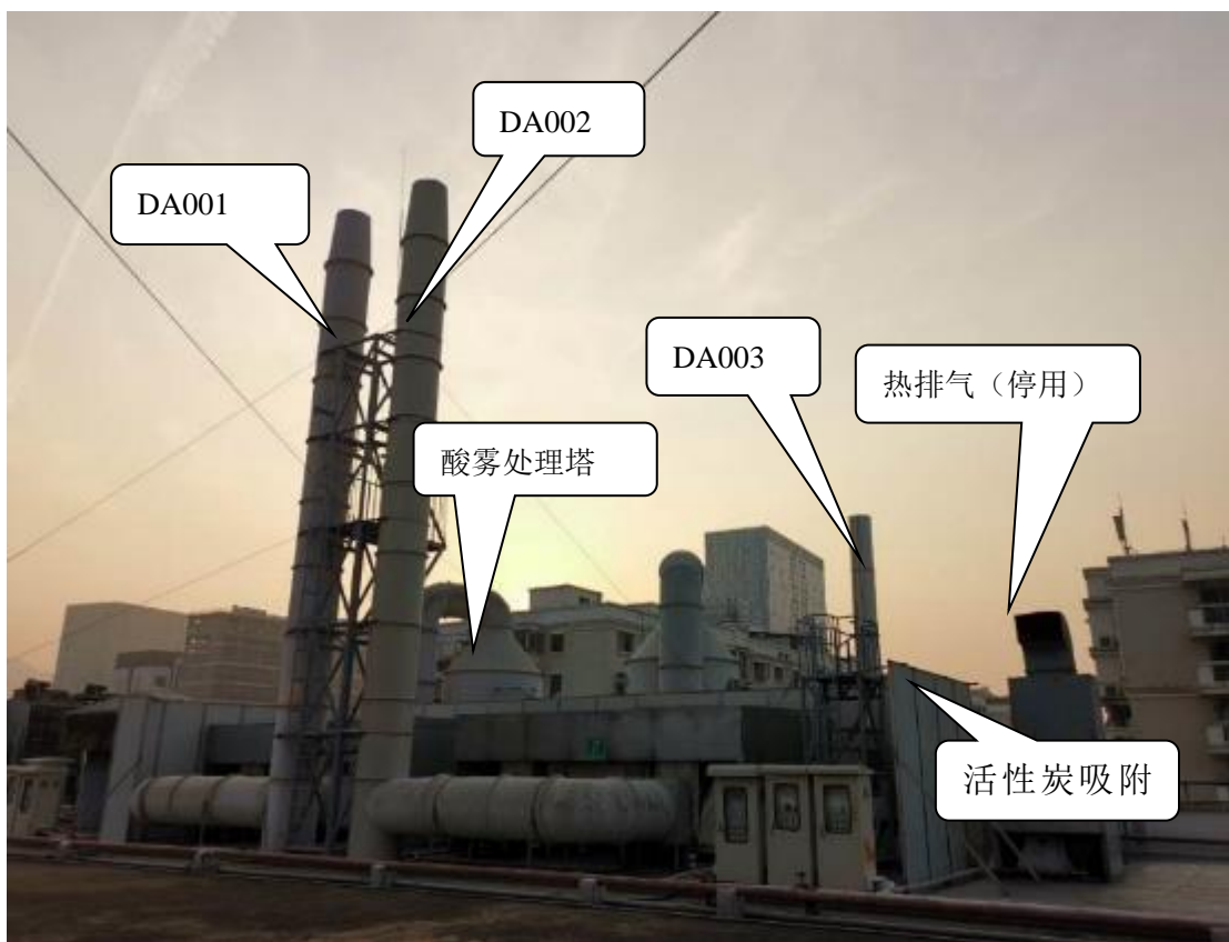
顶楼酸雾废气及有机废气处理设施
