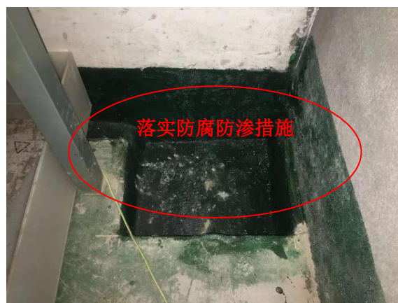
化学品仓库内应急收集槽
