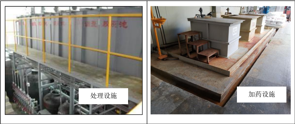
图 4.1.12 电镀废水处理设施
