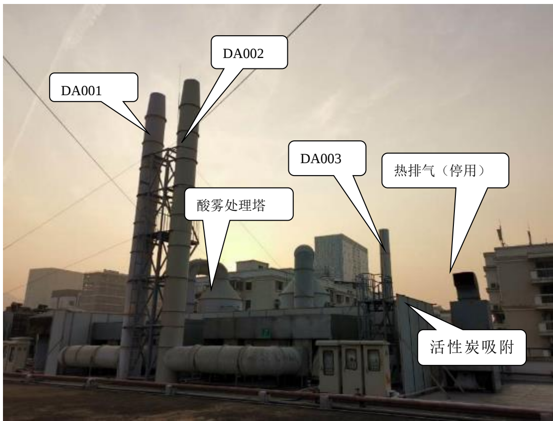
顶楼酸雾废气及有机废气处理设施
